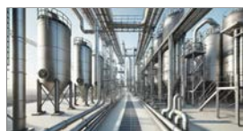
Installations de transport pneumatique
