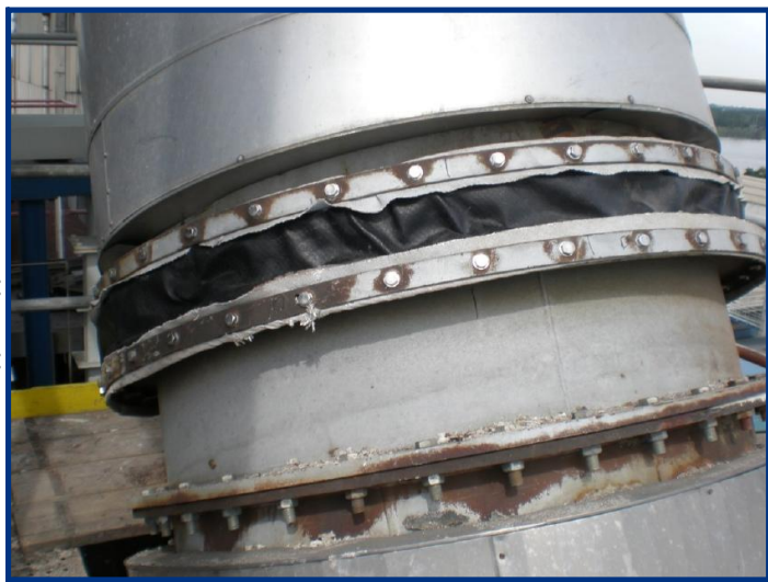
Compensateur multicouches dans le canal de gaz de fumée externe PEKO-LAM (environnement agressif)
