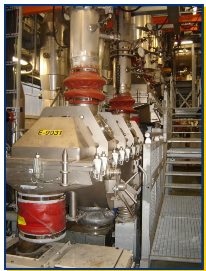
compensateurs dans une installation de séchage
