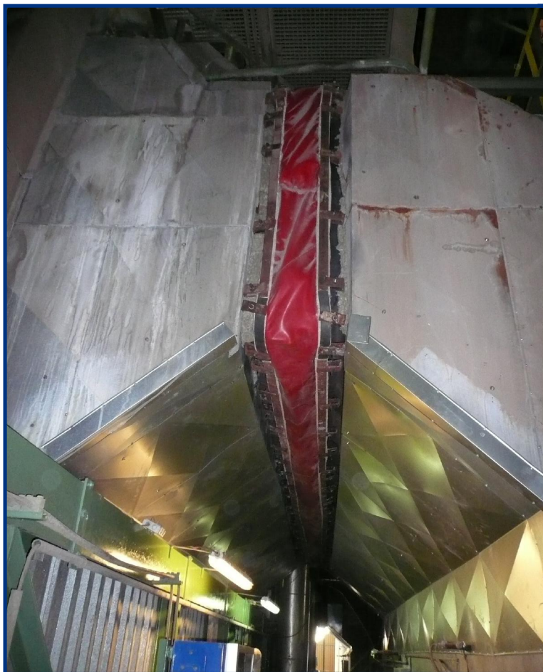
Compensateur entre la sortie de la chaudière et l'électrofiltre
