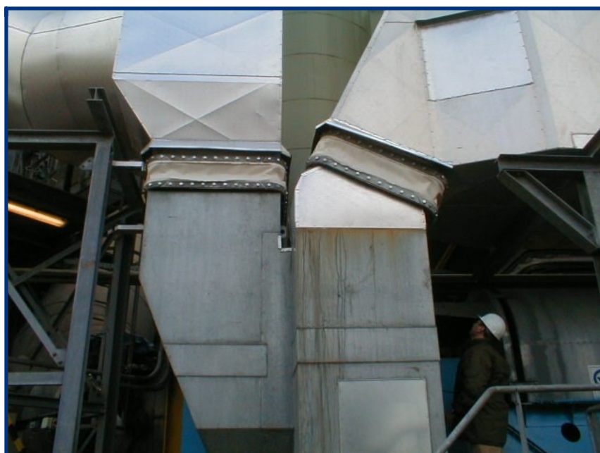
Compensateurs multicouches sur un ventilateur de gaz de fumée
