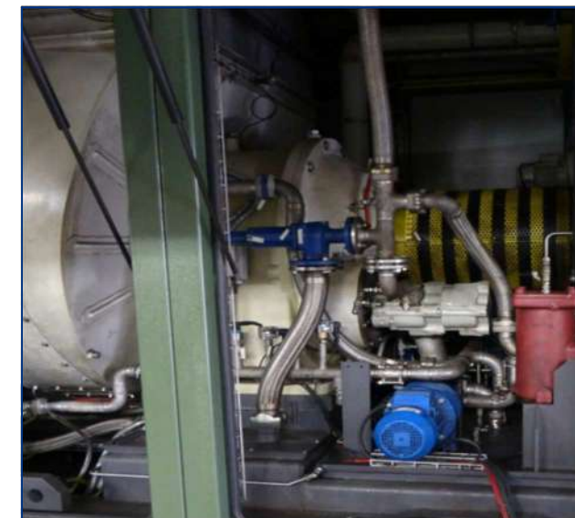
Flexibles pour circuit de refroidissement sur chaudière.
