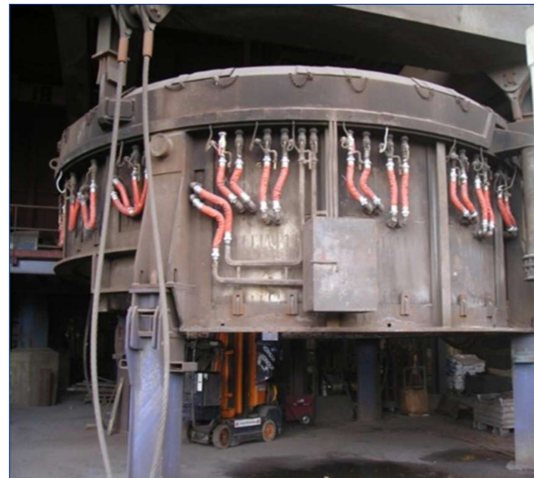
Flexibles isolés sur un circuit de refroidissement d'un four électrique
