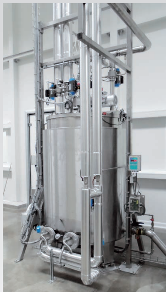
■ Refroidissement farine Fluid Air®
