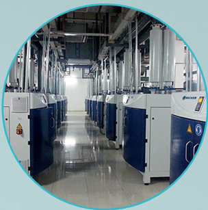
Les installations centralisées
