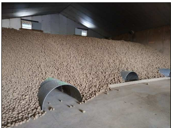
Ventilation pommes de terre par gaines
