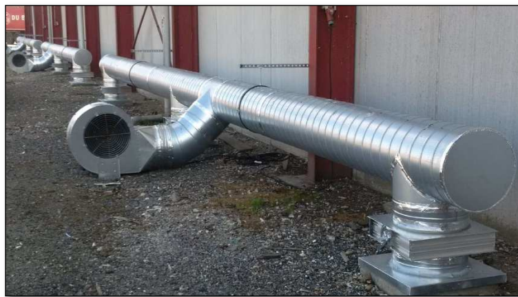
Collecteurs d'air avec ventilateurs centrifuges
