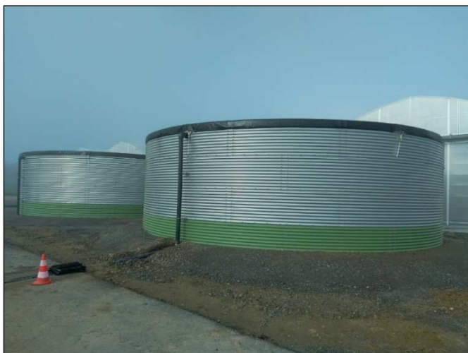
Réserves d'eau semi enterrée
