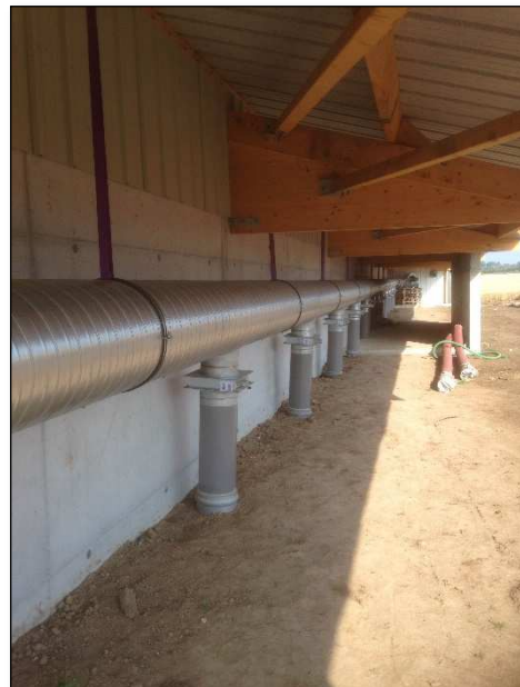
Collecteurs d'air avec caniveaux de ventilation
