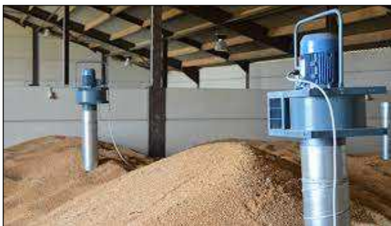
Colonnes de ventilation et vis point chaud
