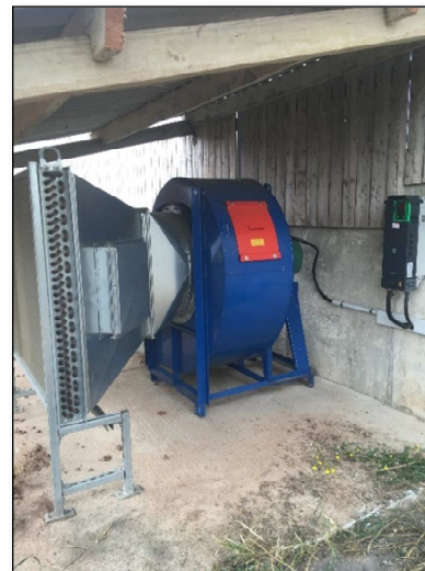
Ventilateurs, batteries chaudes, variateurs de fréquence
