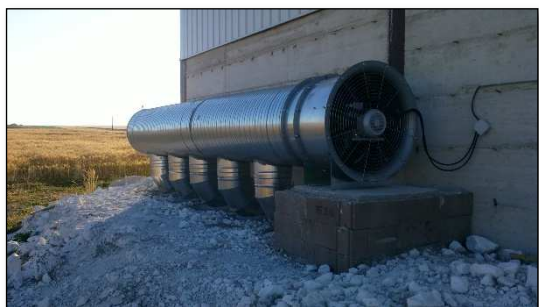
Collecteurs d'air avec ventilateurs axiaux
