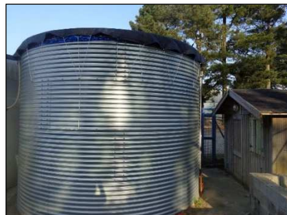
Réserves d'eau de pluie
