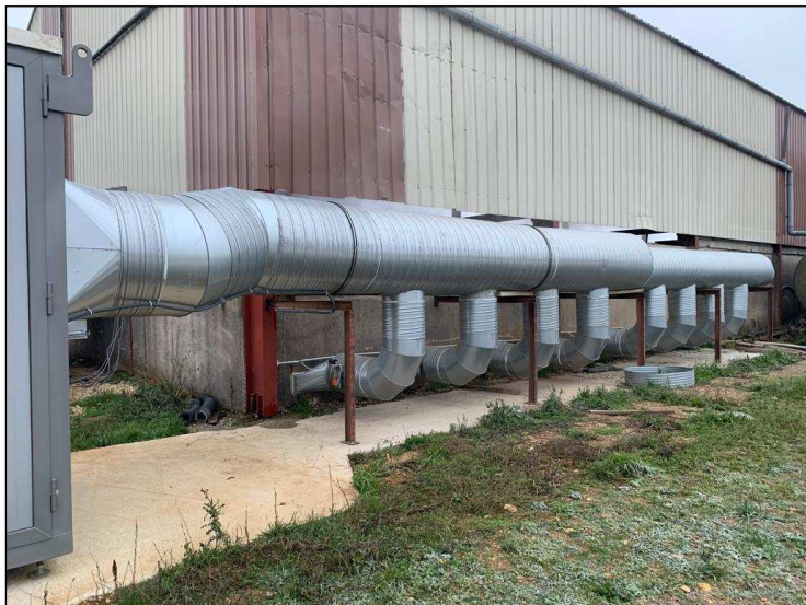
Collecteurs d'air avec planchers perforés carrossables
