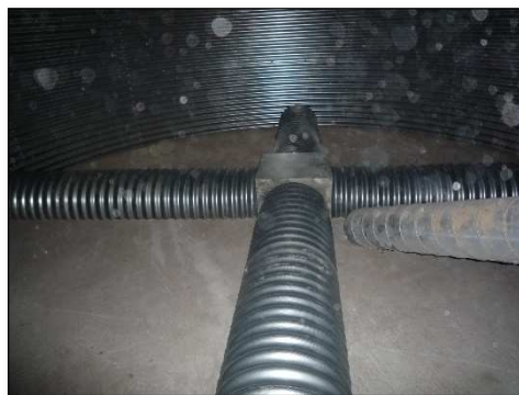
Ventilation par gaines hors sol
