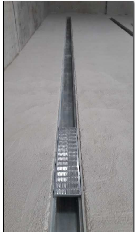
Caniveaux de ventilation
