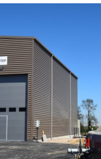
Le site contient deux processus de méthanisation, ici celui des boues de STEP, photo FD
