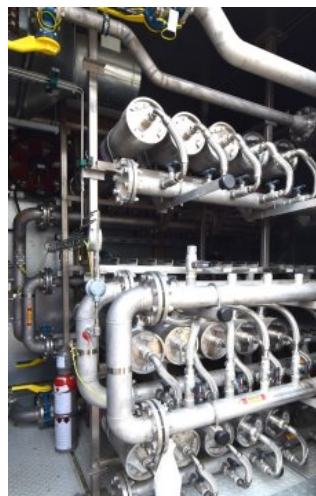
Les filtres membranaires du module EnviThan, photo FD
