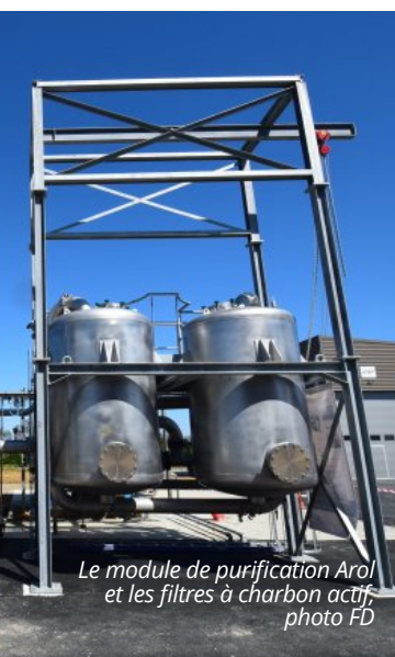
Le module de purification du biogaz à Charentay, photo FD
