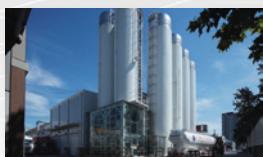
Silo de stockage et système d'extraction
