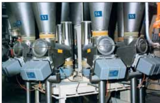
Photo 14 Convoyeur vibrant d'alimentation et de répartition par tubes
