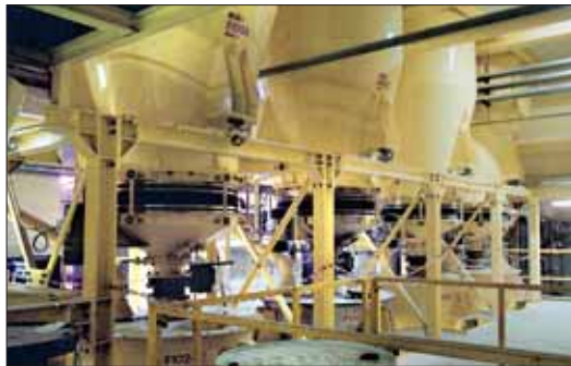
Photo 12 Dispositif de déchargement pour silos SX dans une fabrique de lessive
