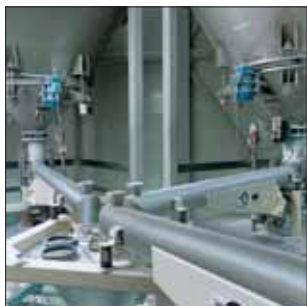
Photo 1 tubes vibrants pour l'alimentation d'un appareil de pesage
