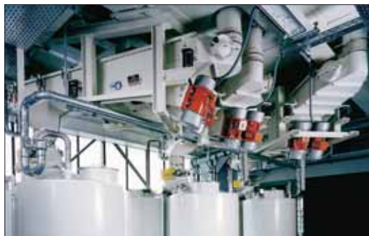
Photo 2 Convoyeur vibrant dans une usine de produits chimiques
