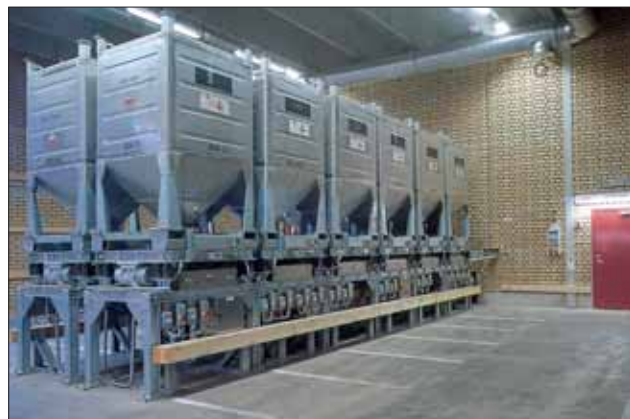
Photo 18 Station de déchargement de conteneurs vibrants alimentant un tube vibrant
