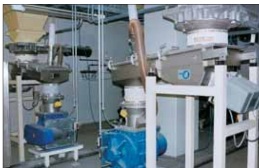
Photo 13 Dispositif de décolmatage de trémie par entraînement électromagnétique
